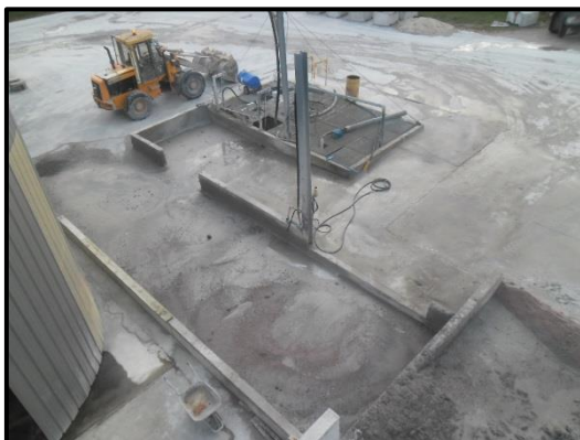
Plateaux de sédimentation de la centrale
